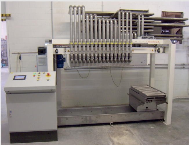
Gravimetrische Abfüllanlage für 32 Komponenten mittels fahrbarer Waage. Alle Komponenten sind mittels Verrohrung verbunden mit festen Lagertanks und IBC Container.
